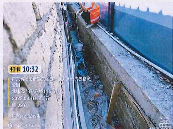
3#支洞生活污水
