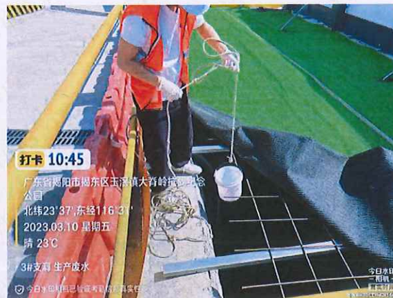
3#支洞生产废水
